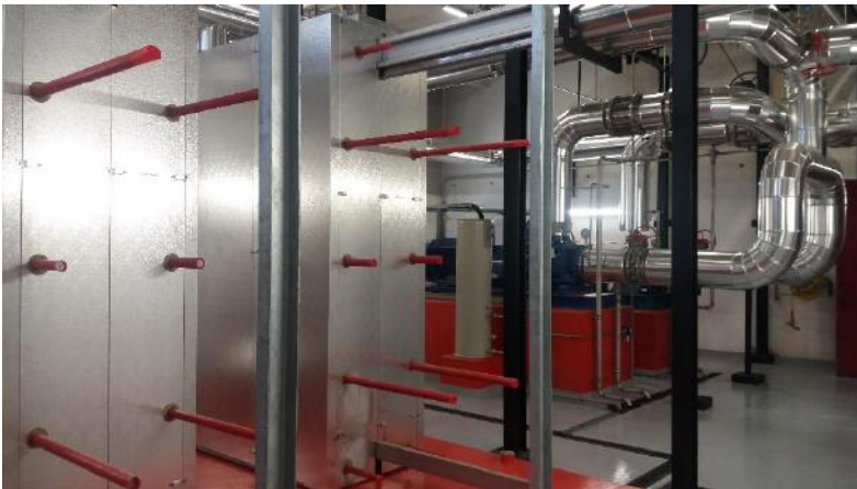
Echangeurs et pompes de réinjection en centrale géothermale.
