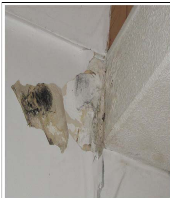
Elément de décoration imitant un dégât des eaux par infiltration non réparée, que le locataire entrant devra embellir lui-même s'il ne le trouve pas à son goût.
